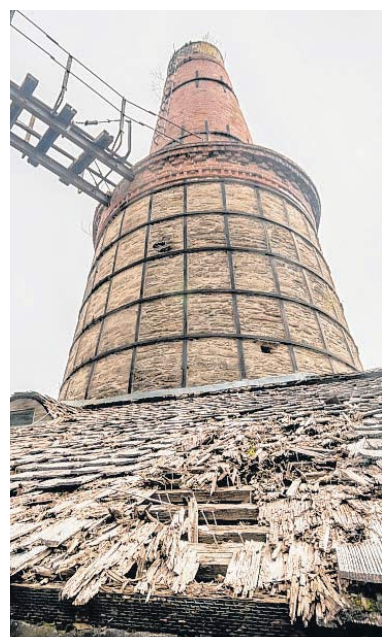
Am Montag beginnen die Arbeiten am Museum Kalkwerk Lengefeld. Das Millionenprojekt umfasst auch das dringend sanierungsbedürftige Holzschindeldach beim Ofen IV. FOTO: KRISTIAN HAHN
